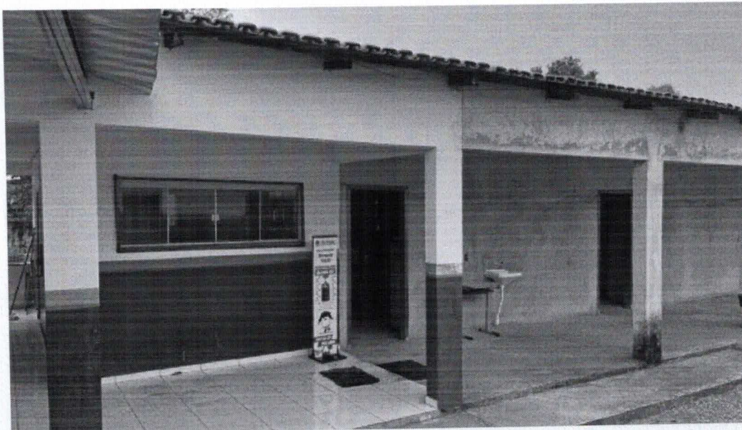
Imagem 06 – Vista frontal das salas cuja ampliação demonstra necessidade de conclusão do acabamento.
